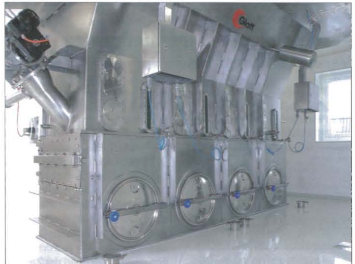
Auf Ebene 1 befinden sich die Zuluftkammern und die Prozesskammer des ProCell 250
